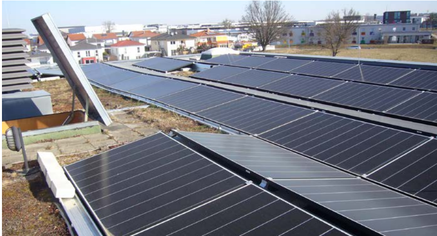
Das Dienstleistungszentrum im Solpark mit Photovoltaikanlage.
